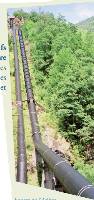
Source de l'Ariège Tarascon (09) Le grand voyage de l'eau commence...dans des tuyaux
