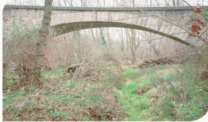
3ème arche du Pont de Bénagues (09) Débit insuffisant, le lit se referme (avant 2004)
